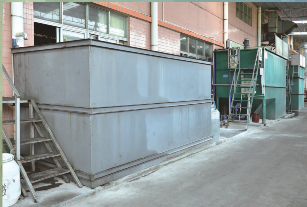
污水处理装置
