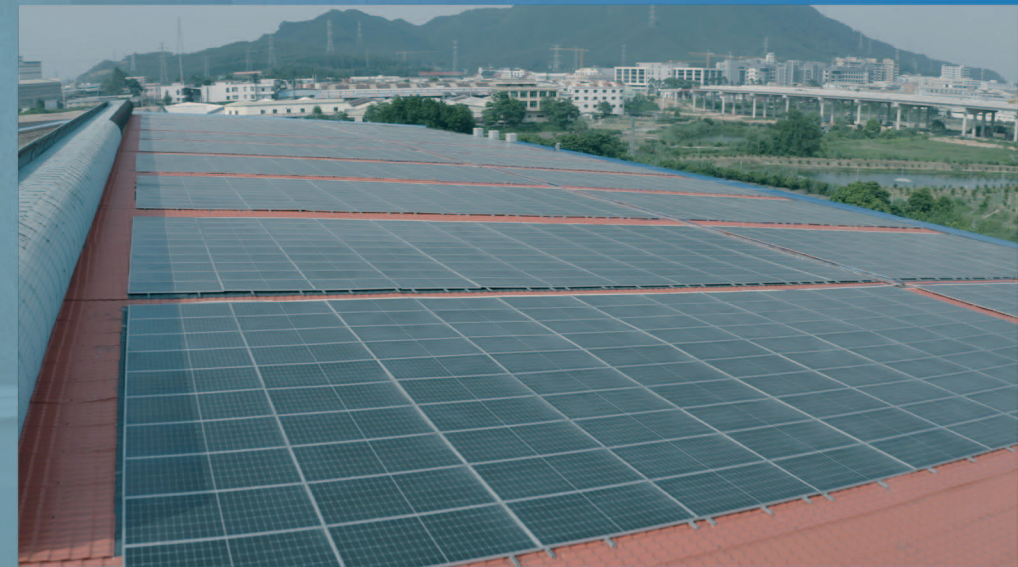
太阳能光伏面板
